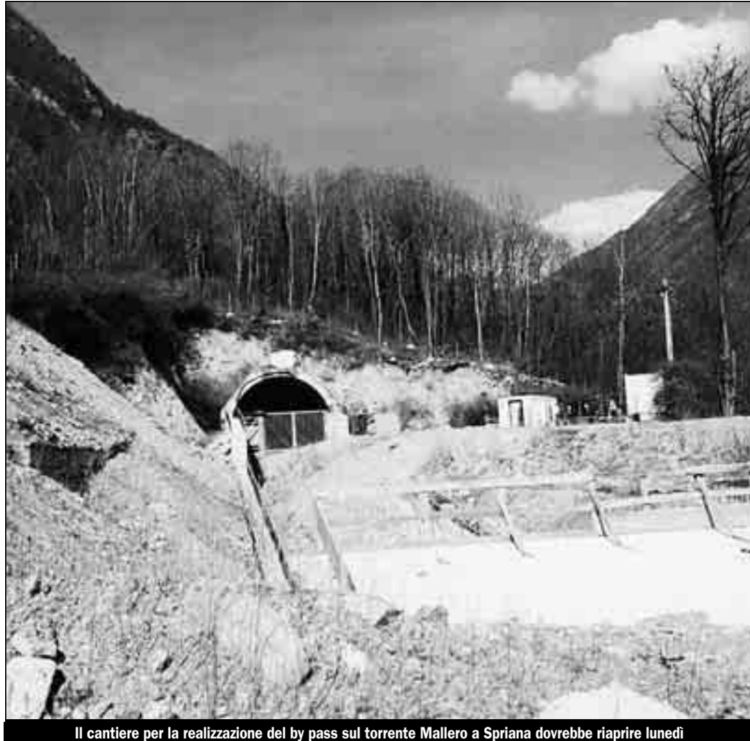
Il cantiere per la realizzazione del by pass sul torrente Mallerio a Spriana dovrebbe riaprire lunedì
