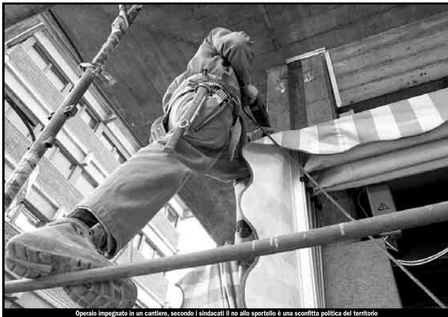
Operaio impegnato in un cantiere, secondo i sindacati il no allo sportello è una sconfitta politica del territorio
